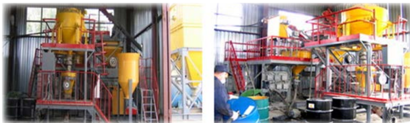
Модульная установка цементирования радиоактивных отходов
