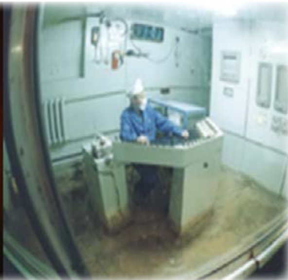
Установка сжигания РАО. Пульт управления
