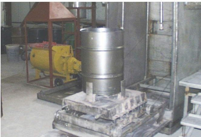
Рис. 13. Установка цементирования зольного остатка Fig. 13. Ash residue cementation plant
