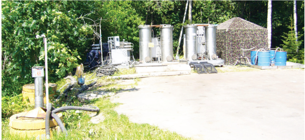
Рис. 3. Установка «Эко» при проведении работ по очистке жидких РАО из емкости-хранилища Fig. 3. Eco plant during liquid radwaste treatment retrieval from a storage tank
