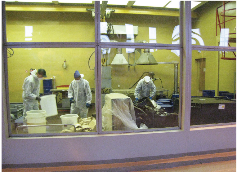
Рис. 8. Рабочая камера для переупаковки, сортировки и фрагментации РАО / Fig. 8. Processing cell for radwaste repackaging, segregation and fragmentation
