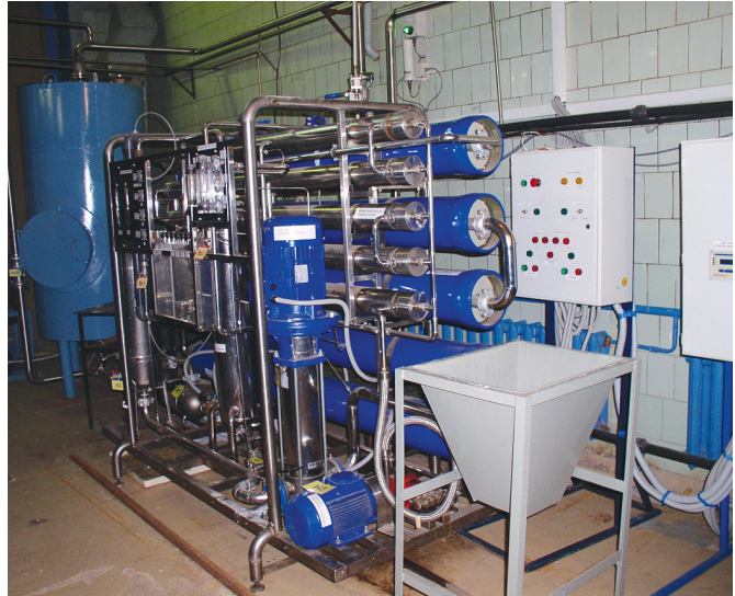
Рис. 5. Двухступенчатая установка обратного осмоса для очистки жидких РАО / Fig. 5. Two-stage reverse-osmosis plant for liquid radwaste treatment
