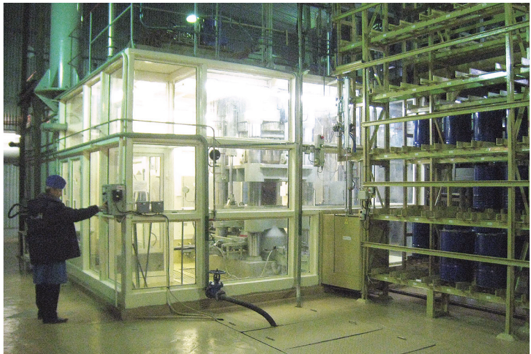
Рис. 9. В центре – воздушно-изолированное помещение, где расположен пресс и вращающийся стол для спрессованных упаковок; справа – фрагмент автоматизированного склада первичных упаковок / Fig. 9. Centre: air-tight room containing a press and turntable for compacted packages; right: fragment of automated primary packages warehouse
