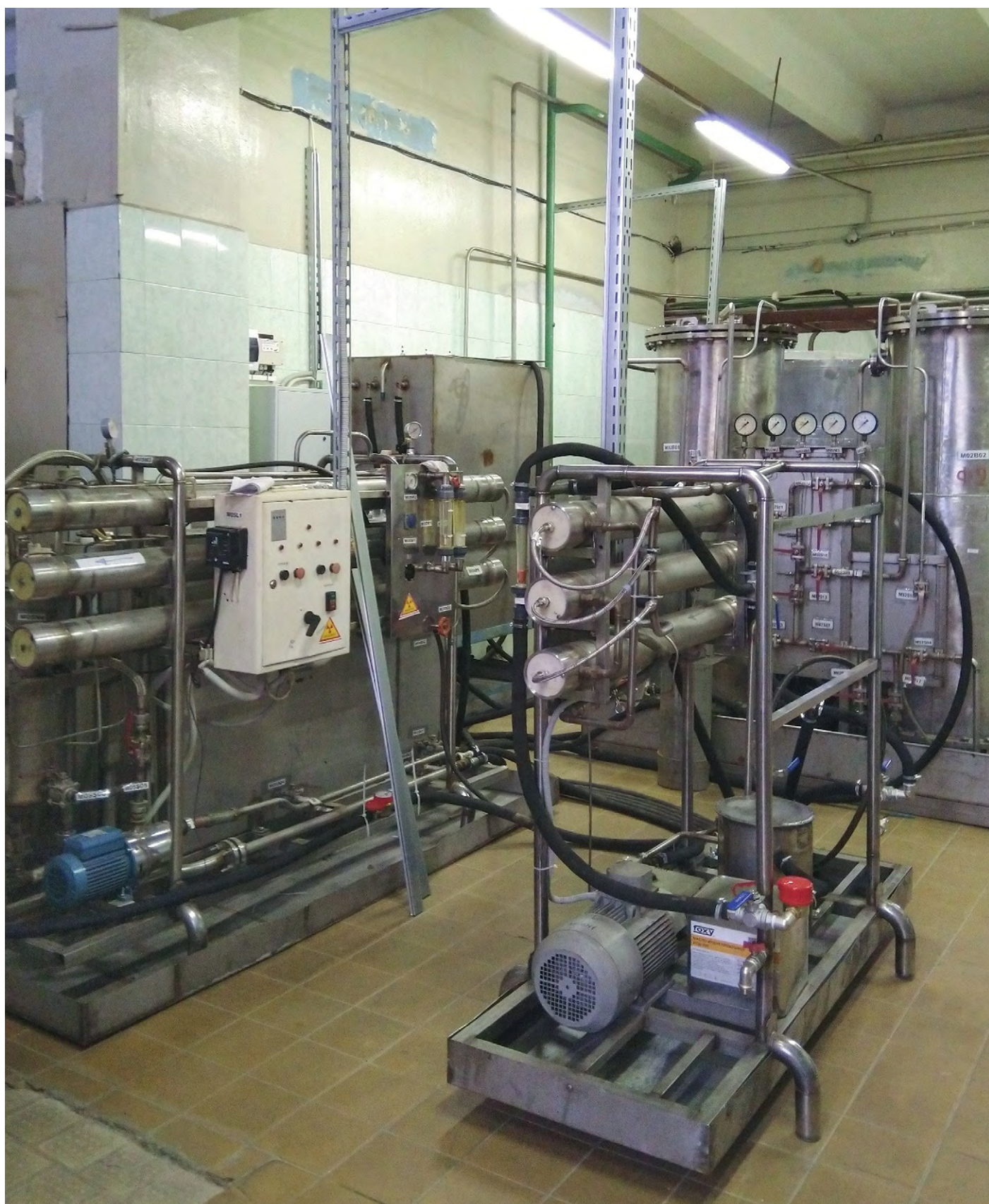
Рис 4 Общий вид системы двухступенчатого обратноосмотического концентрирования ЖРО
