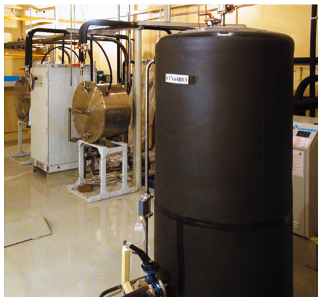
Рис. 2. Генераторы озона и система охлаждения Fig. 2. Ozone generators and the cooling system
