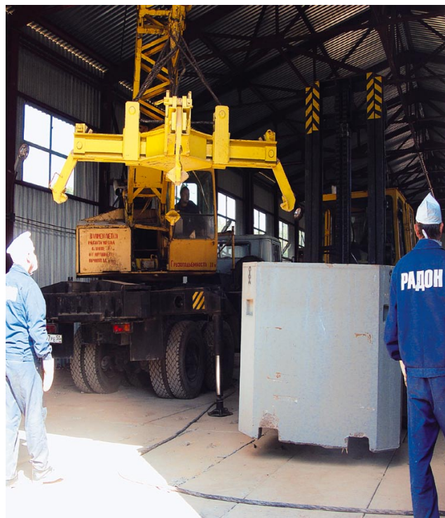
Загрузка контейнера с отходами в хранилище Loading of a waste container into a storage unit
