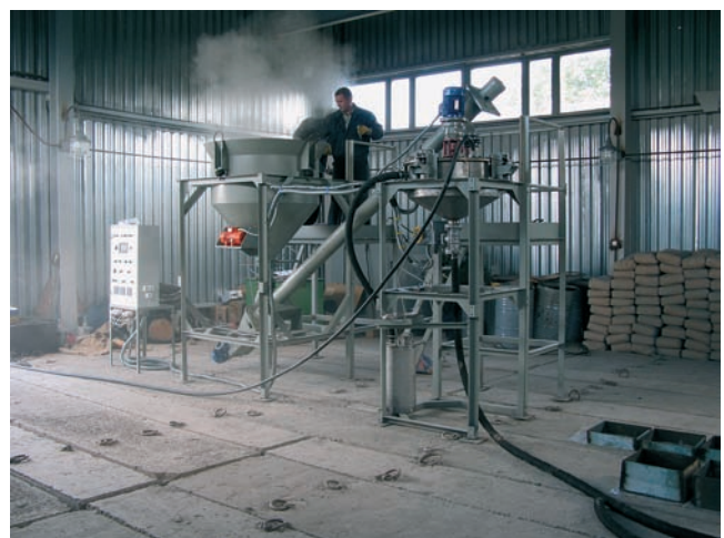
Рис. 4. Модуль цементирования при отверждении тритиевых вод из емкости твердых отходов Благовещенского филиала ФГУП «РосРАО» Fig. 4. Cementation module as used for solidification of tritium-containing water from the solid radwaste storage tank RosRAO in Blagoveschensk
