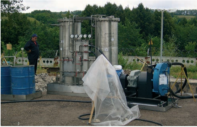
Рис. 3. Водоочистные модули при очистке радиоактивных вод из емкости твердых отходов Благовещенского филиала ФГУП «РосРАО» Fig. 3. Water treatment modules as used for processing of radioactive water from the solid radwaste storage tank RosRAO in Blagoveschensk
